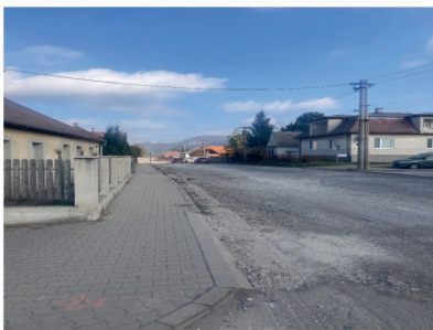
Hlavná cesta pred opravou vozovky
